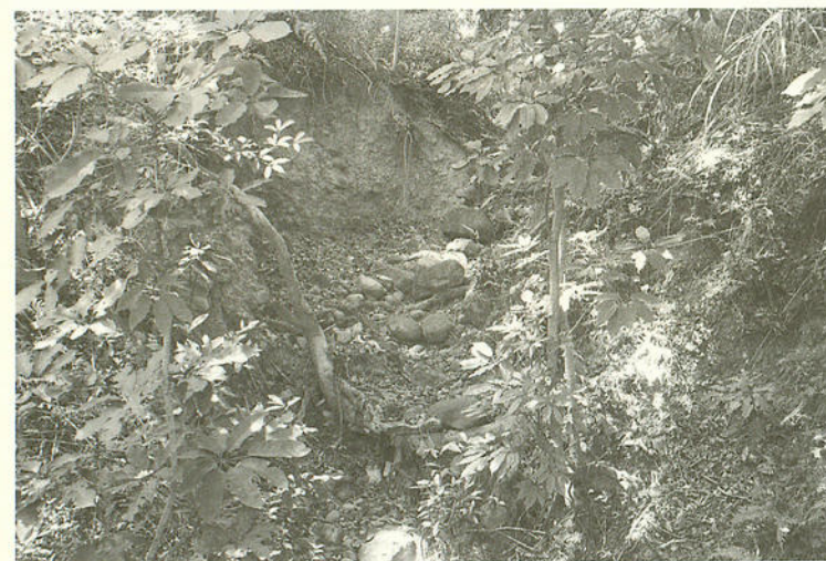
圖四：未受植被保護的地方經常受侵蝕而崩塌
