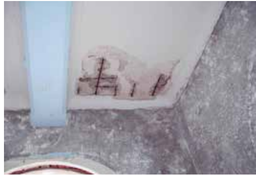
圖42：一樓天花板粉刷層剝落
