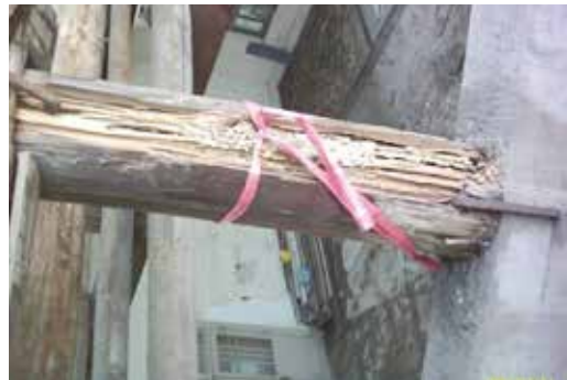
圖58：屋桁腐損情形
