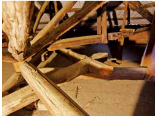
圖23：修復前屋架木材未經加工處理
