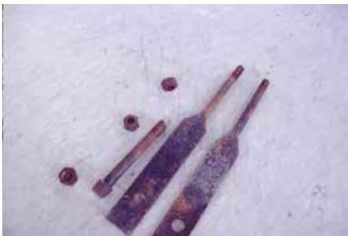
圖55：屋面木構架舊繫件
