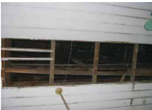
圖13：二樓天花板部分破損
