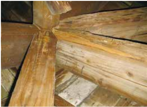
圖11：屋架中柱底部修復前狀況
