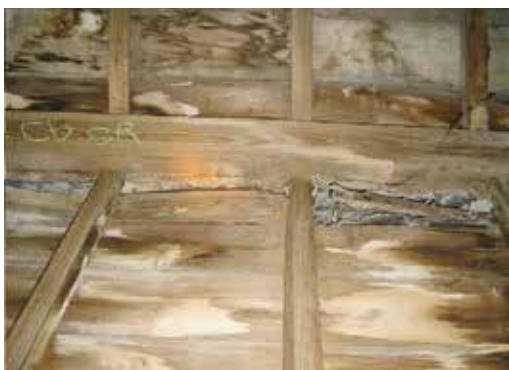
圖9：Cb屋架及天花板修復前狀況
