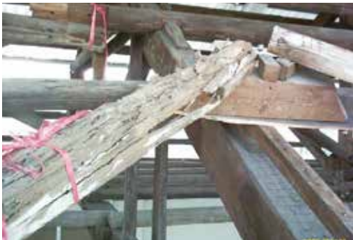
圖57：屋桁端部損壞較明顯
