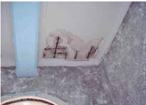
圖91：天花板粉刷層剝落
